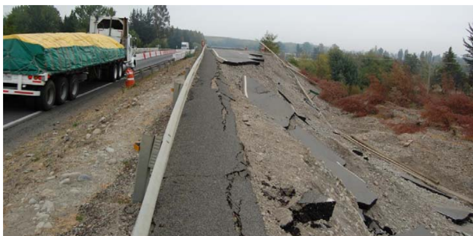
Fig. 4.- Failure of Paso Superior Copihue
